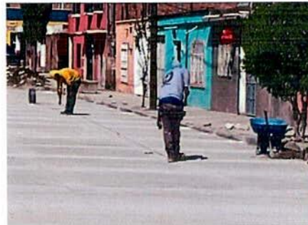
Pavimentación calle Adolfo López Mateos entre Costa Rica a Emilio Portes Gil en Col. López Portillo
