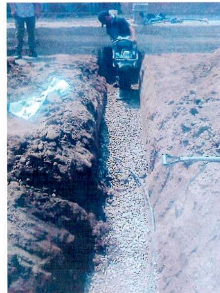
DESCARGAS DOMICILIARIAS EN LA CALLE 5 DE FEBRERO; ENTRE C. 10 DE MAYO Y C. ARROYO SECO COL. CONSTITUCION
