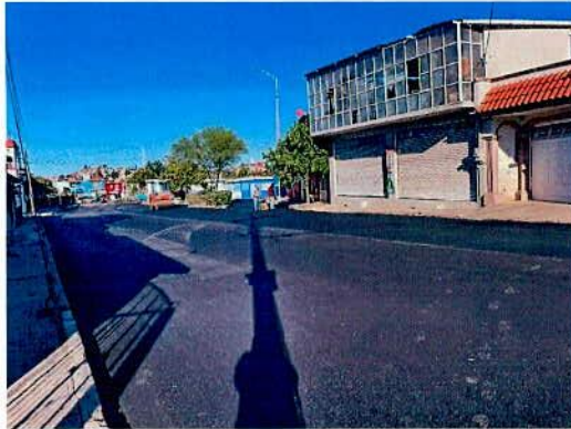
Pavimentación de Calle Pastor Rouaix con Asfalto entre Calle Eduardo G. Cadaval y Calle Alberto Cincunegui en la Col. Héctor Mayagoitia, en el Municipio de Durango, en la Localidad de Durango
