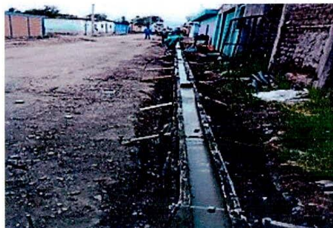
CONSTRUCCIÓN DE GUARNICIONES EN LA CALLE PRINCIPAL; ENTRE EL ACCESO Y EL CANAL POB. IGNACIO LÓPEZ RAYÓN
