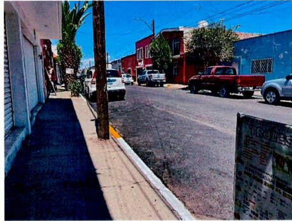
Pavimentación de Calle Gabino Barreda con Asfalto entre Calle Independencia y Av. Dolores del Rio Zona Centro en el Municipio de Durango, en la Localidad de Durango
