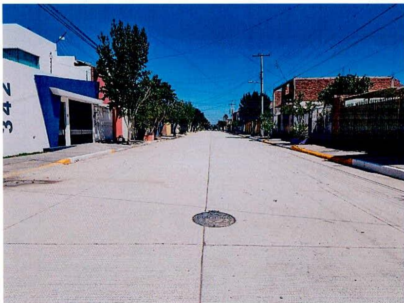
PAVIMENTACIÓN EN LA CALLE JOSÉ ARRIETA 300; ENTRE AVE. DIVISIÓN DURANGO Y C. MARIANO ARRIETA FRACC. GENERAL DOMINGO ARRIETA
