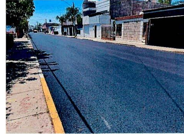
Pavimentación de Calle Reforma con Asfalto entre Blvd. Cnel. Enrique Carrola Antuna y Calle Mascareñas de la Col. Porfirio Díaz, en el Municipio de Durango, en la Localidad de Durango
