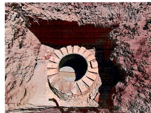
REHABILITACIÓN DE ALCANTARILLADO EN LA CALLE COAHUILA; ENTRE C. MÉXICO y 10 DE FEBRERO COL. MEXICO
