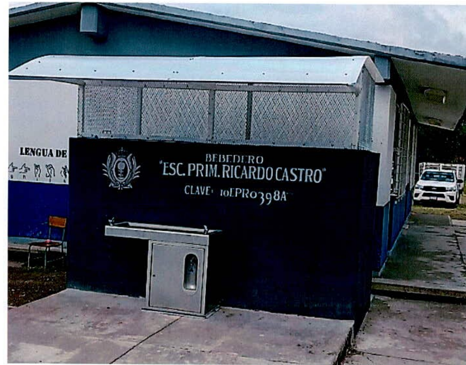
SUMINISTRO E INSTALACIÓN DE BEBEDERO ESC. PRIM. "RICARDO CASTRO" CLAVE: 10EPR0398A COL. LAS PALMAS
