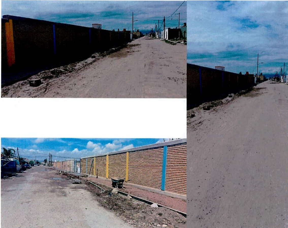
GUARNICIONES Y BANQUETAS EN AV. ARBOLEDAS ENTRE C. DALÍ Y REAL VICTORIA; EN C. REAL VICTORIA ENTRE AV. ARBOLEDAS Y C. DALÍ; Y, C. DALÍ ENTRE AV. ARBOLEDAS Y REAL VICTORIA. , FRACC. REAL VICTORIA II
