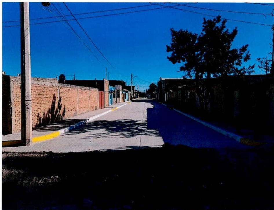
CONSTRUCCIÓN DE PAVIMENTO EN CALLE BOGONIA 100, ENTRE AV. PASEO DE LA FERRERÍA Y VALLE VERDE COL. VALLE DEL SUR
