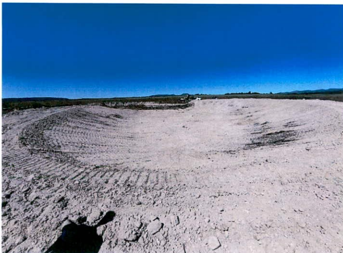
OLLA PARA CAPTACIÓN DE AGUA POBLADO SAN BENITO
