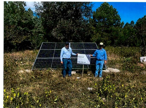
EQUIPAMIENTO DE POZO POBLADO SANTA LUCÍA
