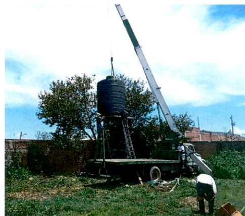
TANQUE DE ALMACENAMIENTO POBLADO SAN IGNACIO
