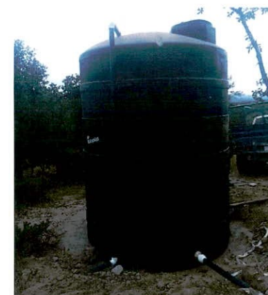
TANQUE DE ALMACENAMIENTO POBLADO NAVAJAS
