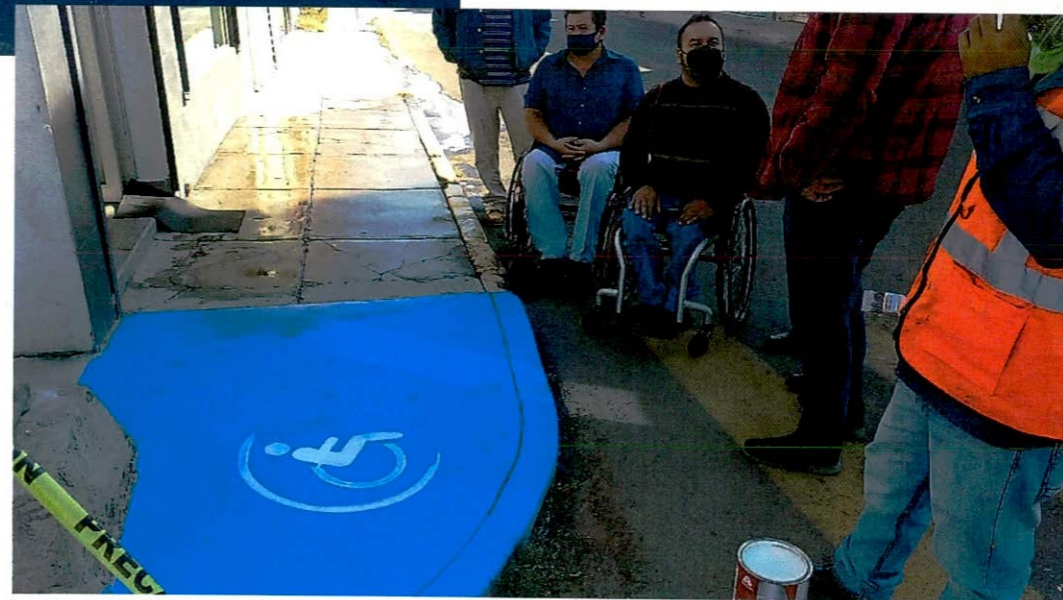
BANQUETAS EN LA CALLE LAUREANO RONCAL
