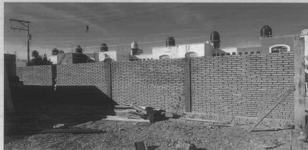
BARDA PERIMETRAL EN ESC. SEC. VALLE DEL GUADIANA FRACC. VALLE DEL PASEO
