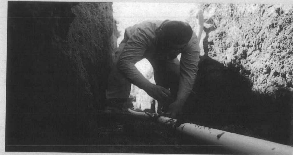
LÍNEA DE AGUA POTABLE EN CALLE TAURO, CALLE TEMAZCAL Y LÍMITE DEL CERRO COL. VALENTÍN GÓMEZ FARÍAS
