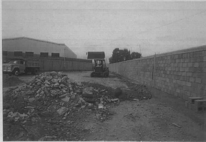
CALLE JOSE ÁNGEL SALAS LUNA CONSTRUCCIÓN DE BARDA COLINDANTE SEGURIDAD PÚBLICA CARRETERA A MÉXICO
